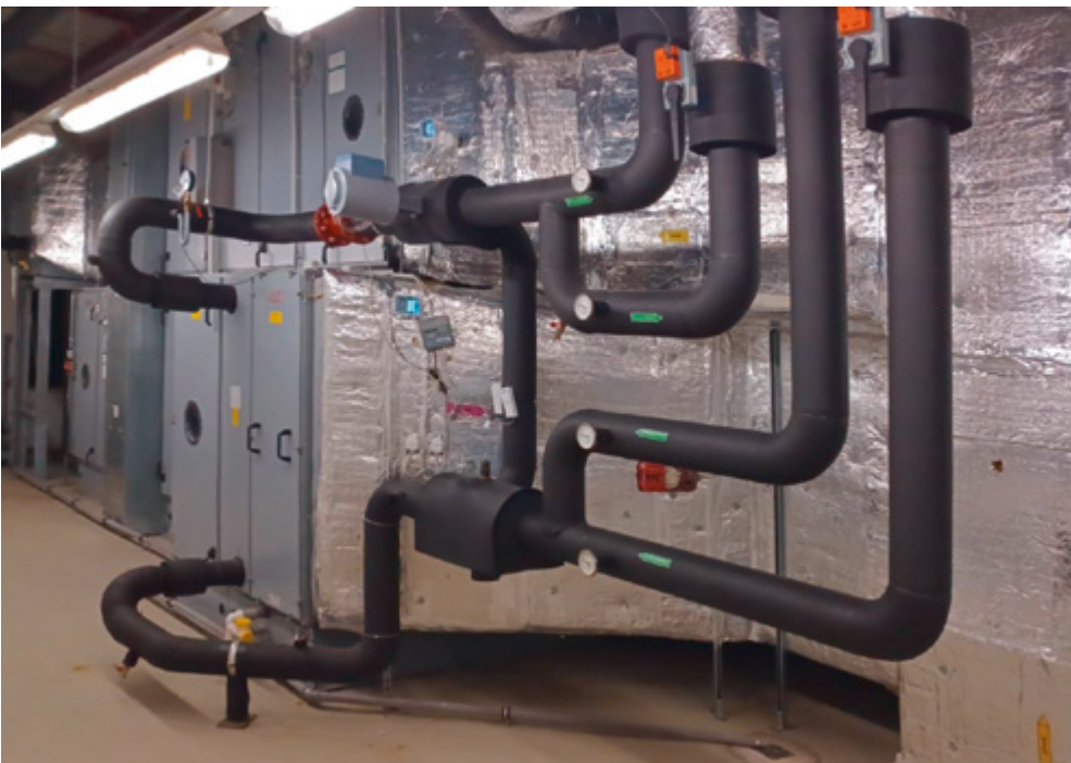
Abbildung 19: RLT-Zentrale mit Medienversorgung
